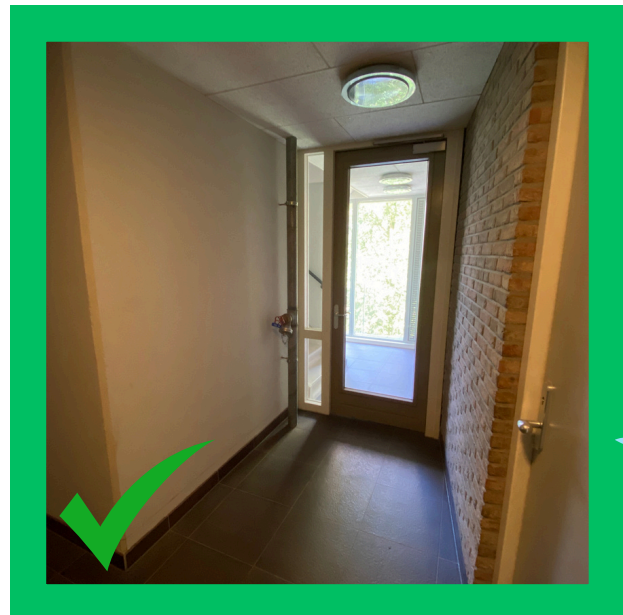
De brandweer moet altijd bij de brandslang kunnen.
